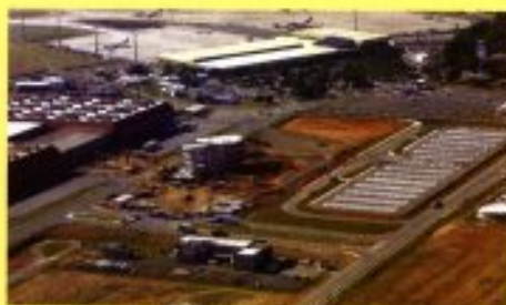
Construção do Edifício Administrativo e Anexo do TECA | Construction of cargo terminal administrative building and annexe
