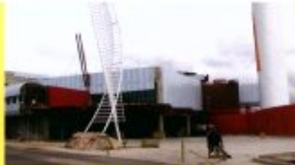
Construção do novo Terminal de Passageiros e ampliação do sistema de pistas e pátios Construction of new passenger terminal, expansion of runways and concourse
