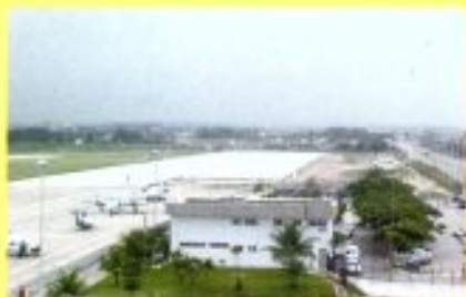
Ampliação do pátio de aeronaves e implantação da pista de táxi | Expansion of the concourse and creation of a taxiway
